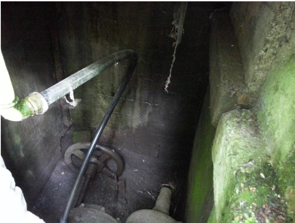
Unterirdischer Revisionsschacht unter den Gleisen als potenzielles Winterquartier für Fledermäuse oder Steinmarder-Versteckplatz (Aufnahme: 18.5.2014)
